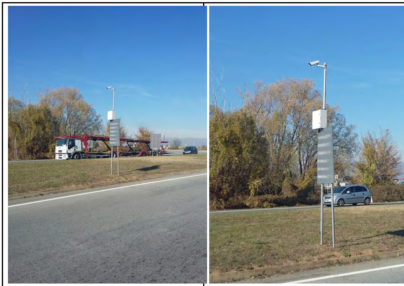
Installazione videocamera IP su segnaletica verticale esistente
